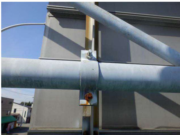
標識板継手の腐食の例
