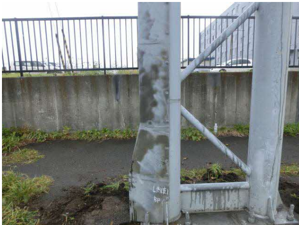
支柱の変形の例
