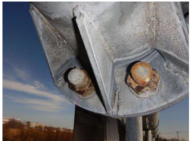
継手部ボルトの腐食の例
