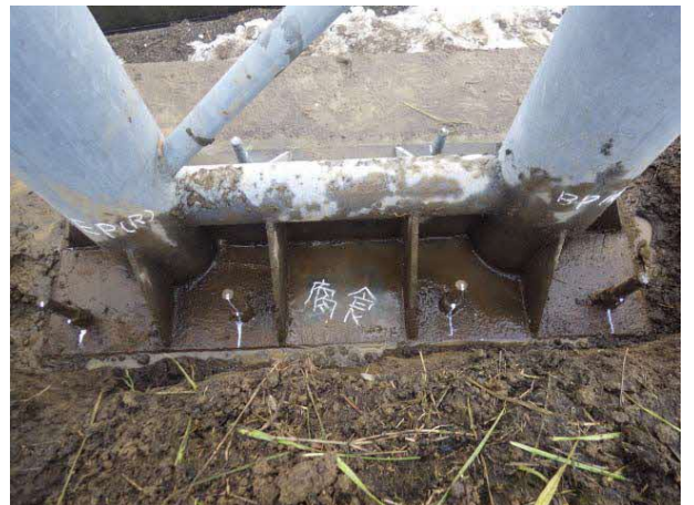
ベースプレートの腐食の例
