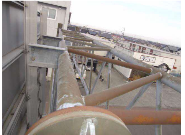
横梁の腐食の例
