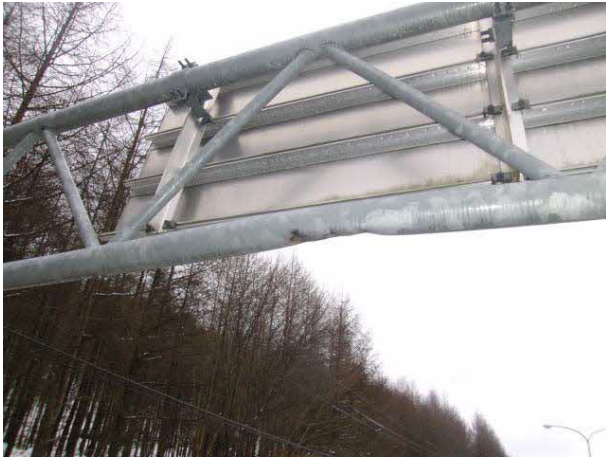
横梁の変形の例
