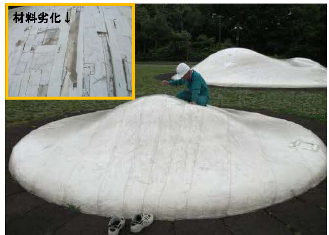
【道南四季の杜公園】材料が劣化した遊戯施設
