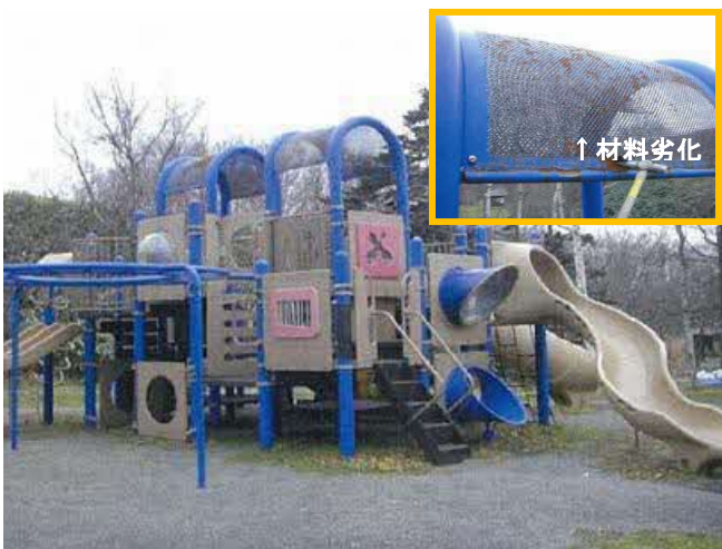
【宗谷ふれあい公園】材料が劣化した遊戯施設
