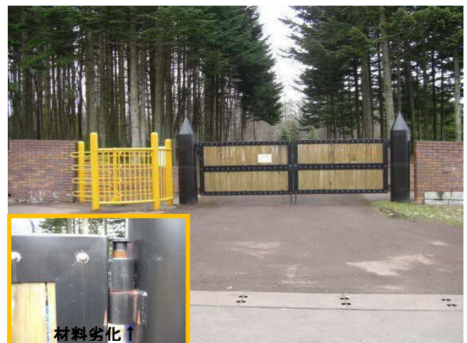
【北海道子どもの国】材料が劣化した門扉
