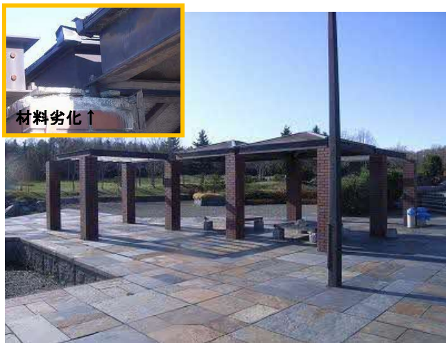
【野幌総合運動公園】柱、屋根が破損した休憩施設
