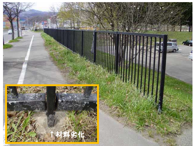
【真駒内公園】支柱が劣化した転落防止柵
