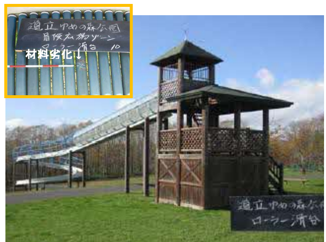
【ゆめの森公園】材料が劣化した遊戯施設
