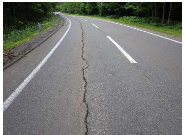
凍上によるひび割れ状況
