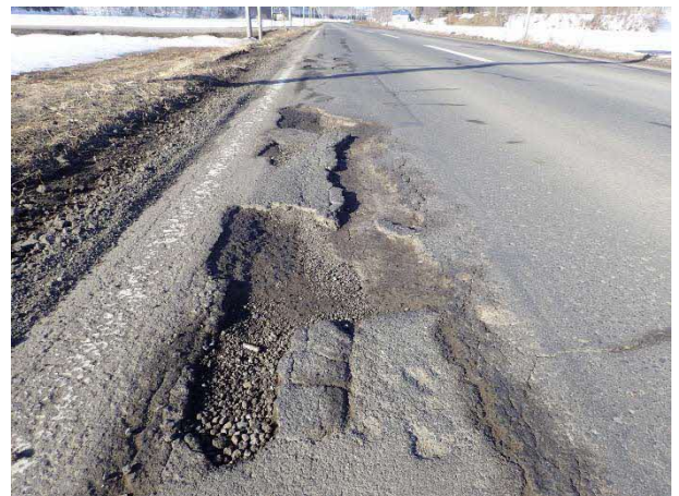
凍結融解の繰返しによるポットホール（剥離）
