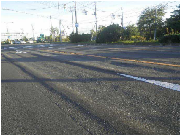
大型車両増加によるわだち掘れ状況
