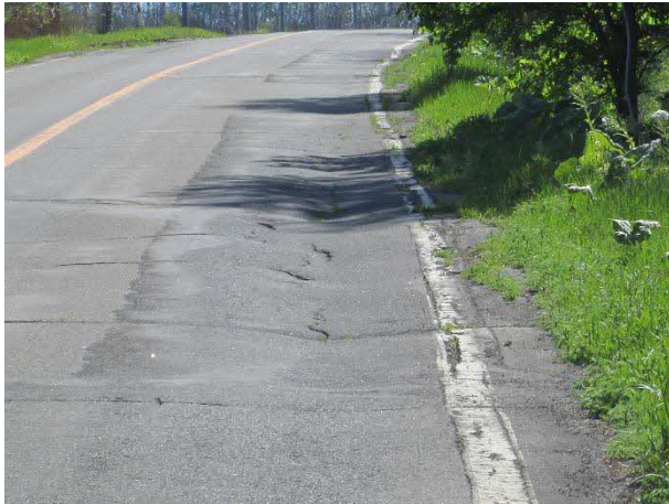
沈下による平坦性の悪化
