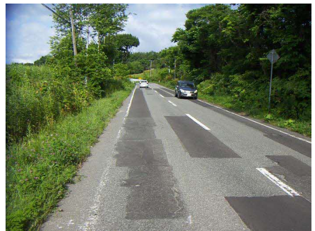
点在したパッチングによる平坦性の悪化
