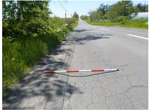
沈下による平坦性の悪化
