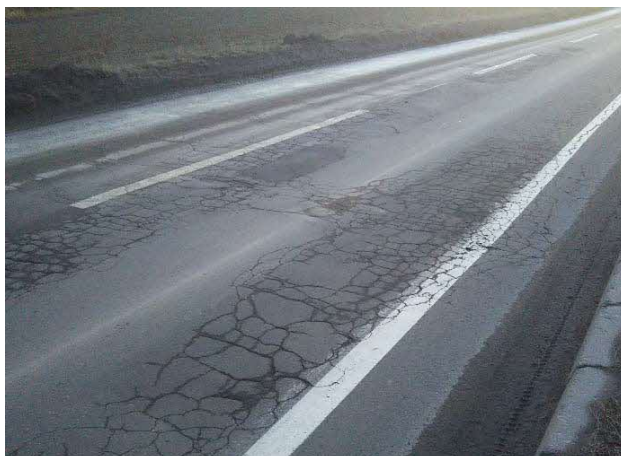
支持力低下によるひび割れ状況
