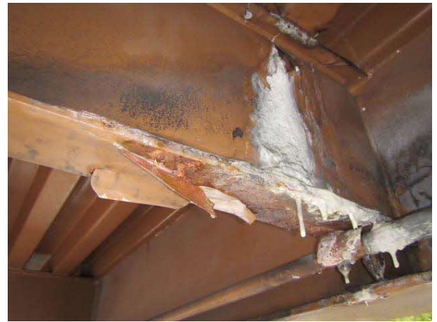
漏水による腐食例
