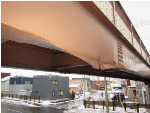
鋼製部材の変形（亀裂）例
