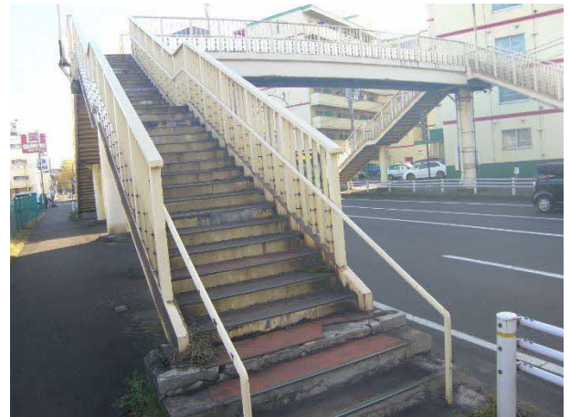
階段部の腐食例
