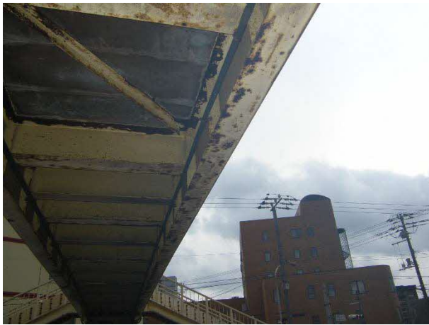
鋼製部材の腐食例
