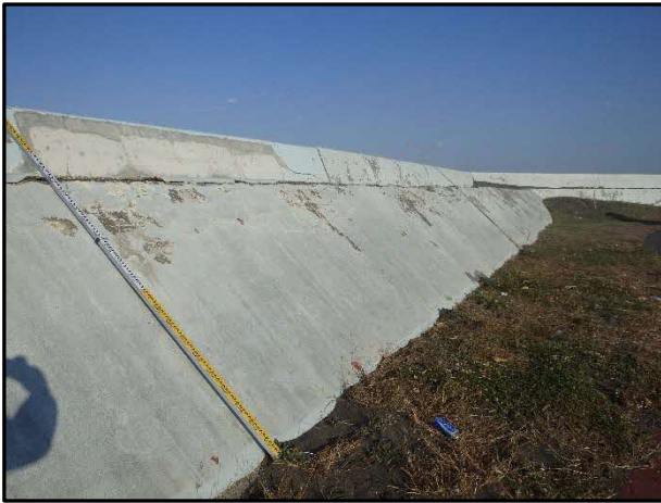
裏法被覆工のひび割れ
