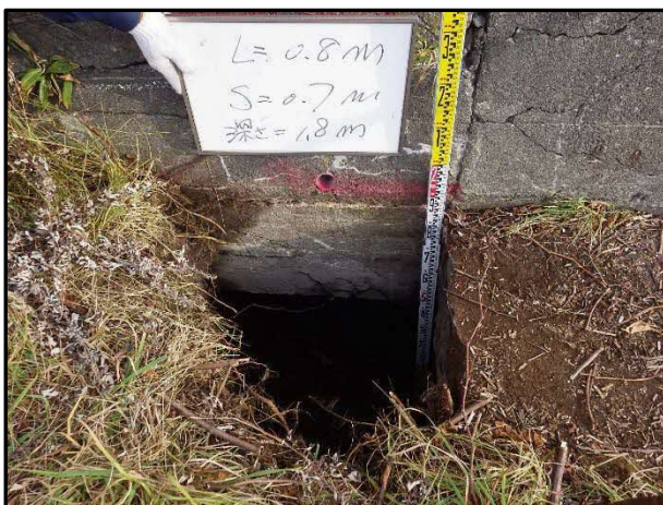
天端被覆工の陥没
