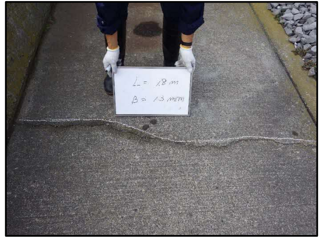
天端被覆工のひび割れ
