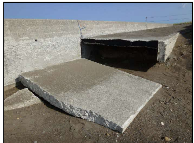
天端被覆工の倒壊
