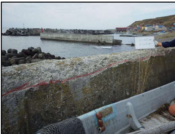
波返工の剥離・損傷
