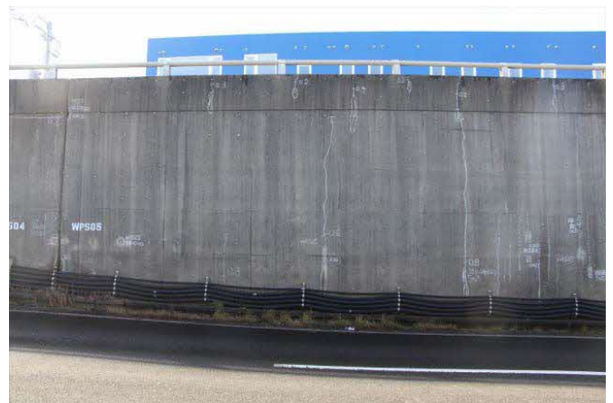
擁壁のひび割れ例
