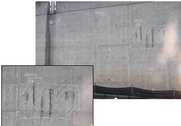
主部材のはくり例
