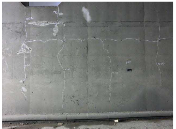
主部材のひび割れ例
