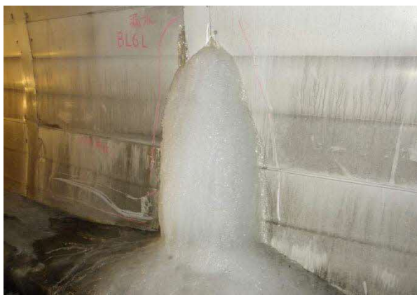
漏水(氷柱)の例
