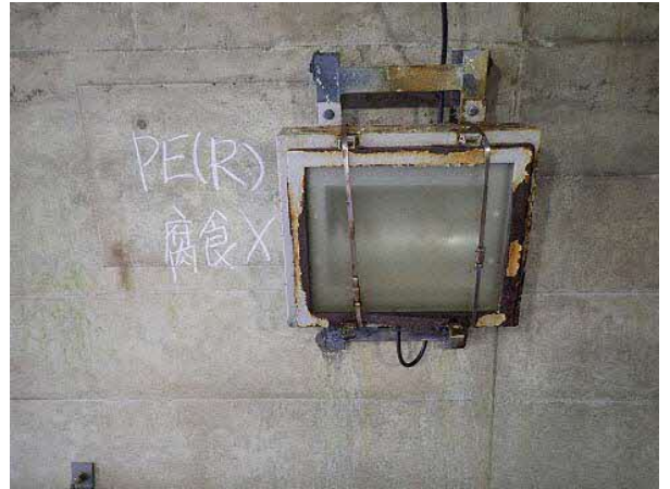
附属施設の腐食の例
