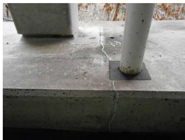
受台のひび割れ例
