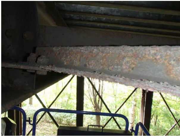
鋼製部材の腐食例
