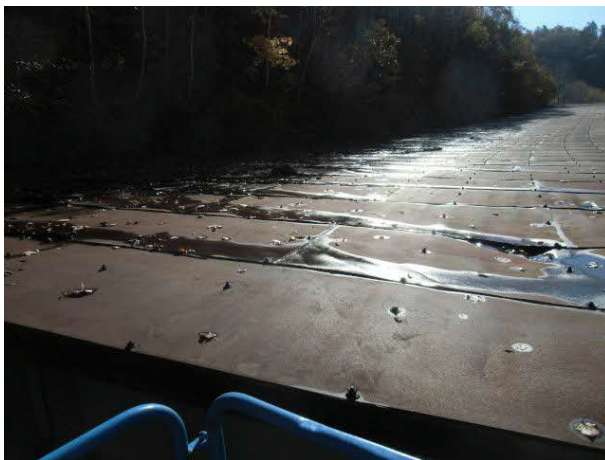
鋼製部材の変形例
