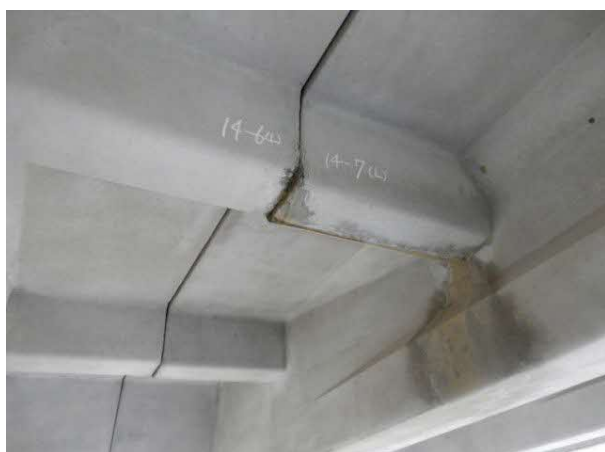
目地からの漏水例
