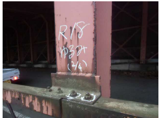
鋼製部材のゆるみ例
