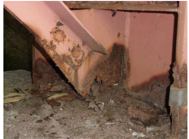
鋼製部材の亀裂例
