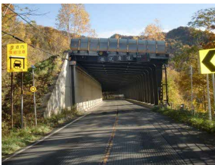
(鋼製) 《ロックシェッド》
