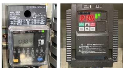
左：コンプレッサー自動停止用タイマー 右：バキュームポンプ制御用インバーター
