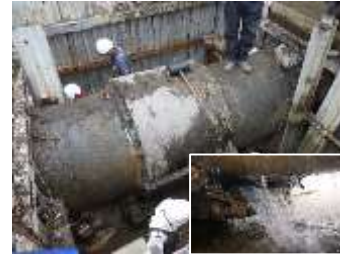
北海道胆振東部地震に伴う漏水
