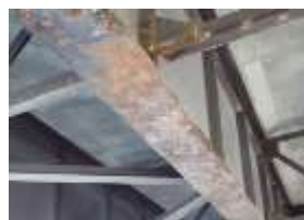
橋梁の老朽化
