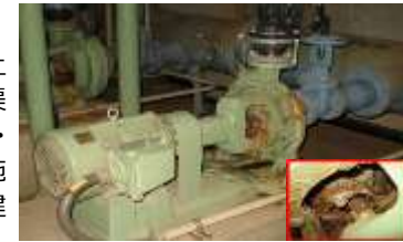
下水道施設の老朽化
