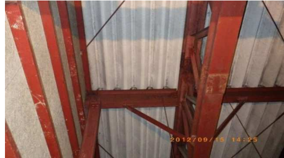
屋根用折板裏石綿断熱材
