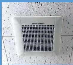
天井設置の換気扇
