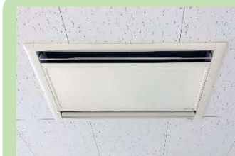
天井設置の熱交換換気
