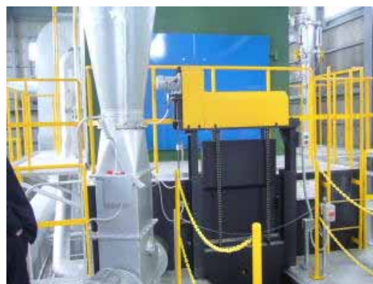
～ボイラー本体～
