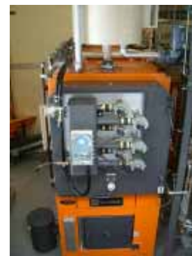
～ ボイラー本体～
