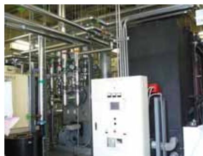
～ ボイラー本体～
