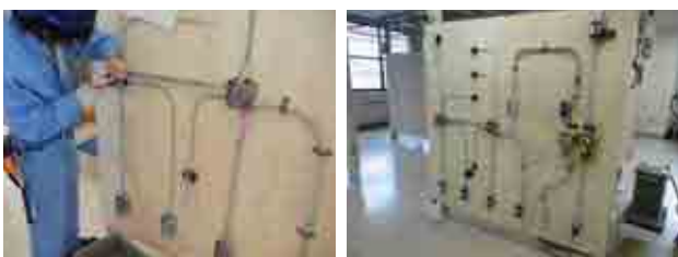
配電制御盤実習
