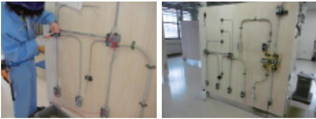
配電制御盤実習
