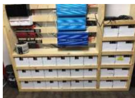
搭載電源／蓄電池システム 30kwh リチウムイオン 合計 4.5kw の出力装置群
