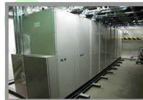
9 台のヒートポンプ エネルギー量にあわせて、必要な台数が稼動する。
