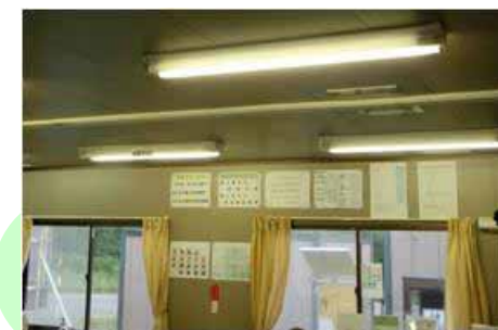
LED蛍光灯（現場事務所）
