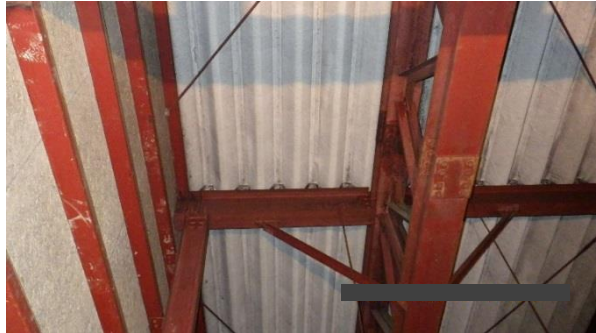
屋根用折板裏石綿断熱材
