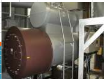
㉕「新設ボイラー（混合ボイラー）」 再生魚油を燃焼させるボイラー。
