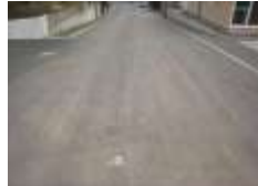
2冬経過後の路面状況(3工区,溶融スラグ30%)
