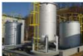
原料タンク設備
