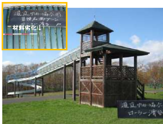
【ゆめの森公園】材料が劣化した遊戯施設
