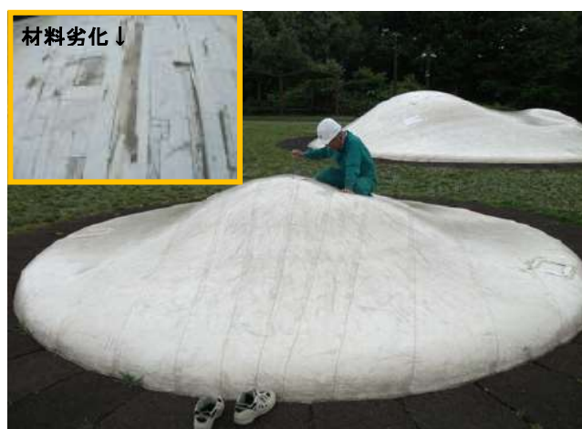
【道南四季の杜公園】材料が劣化した遊戯施設
