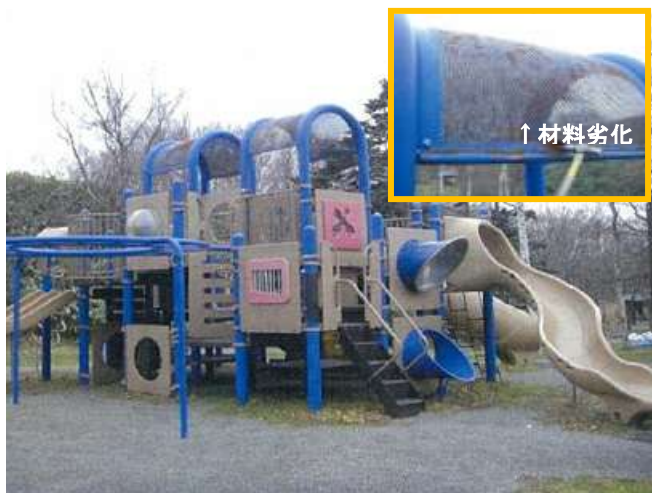
【宗谷ふれあい公園】材料が劣化した遊戯施設
