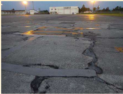
舗装劣化状況
