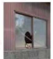
窓が割れた 管理不全空家
