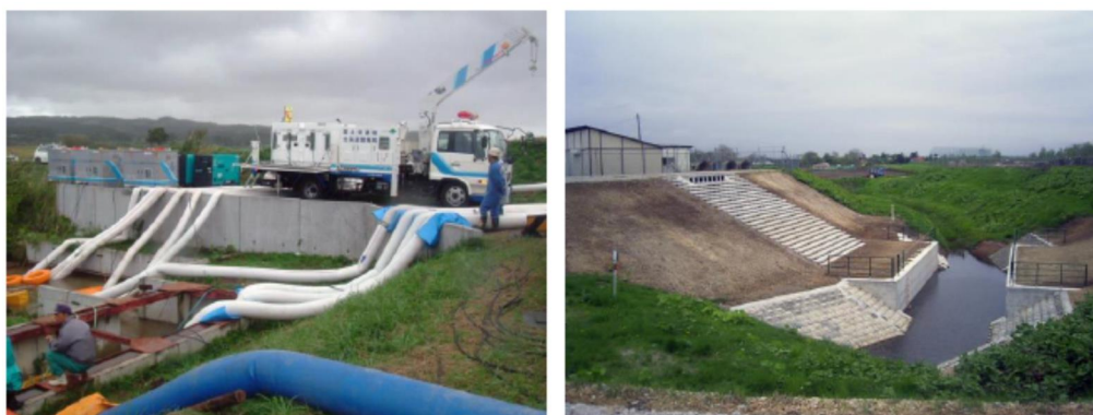
写真 4-1 排水釜場と排水ポンプ車の例
