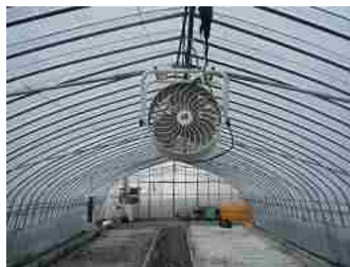
写真 循環送風機を設置した育苗ハウス
