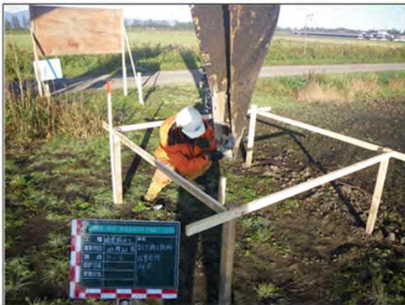
日常点検 (位置座標の確認)
