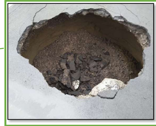
管渠老朽化による道路陥没 (R4)
