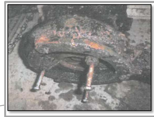
処理施設の老朽化(原水ポンプ) (R3)
