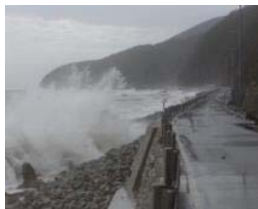
現道の越波の状況
