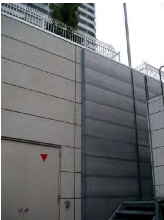
冷却塔横に設置した吸音板
