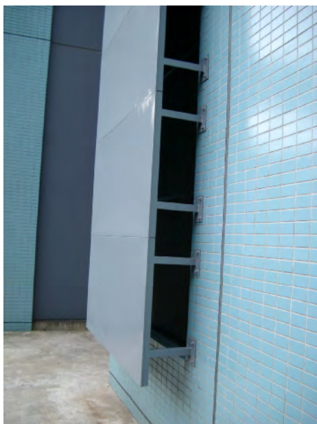
ガラリ外部に設けた遮音板
