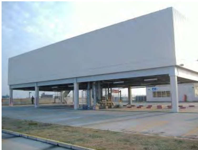
屋上氷蓄熱冷却塔 防音・目隠し壁
