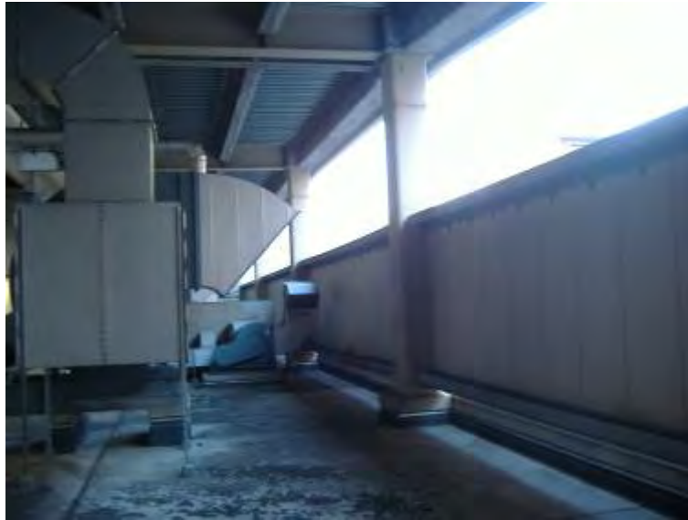
空調室外機置き場 防音・目隠し壁
