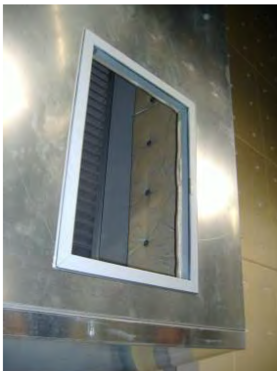
機械室 ガラリ内側の吸音材貼り付け ダクトがガラリに面する場所に箱状の空間を設置し、吸音材を内張りしている。
