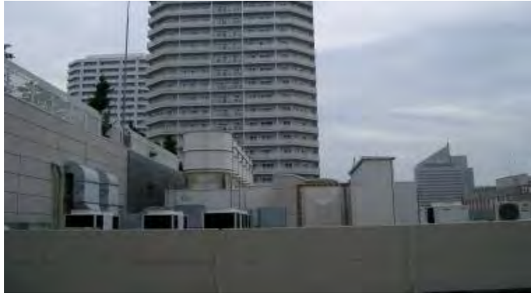
屋上における設備機器類の集中配置 騒音レベルの大きい機器を集合住宅から離して設置している。
