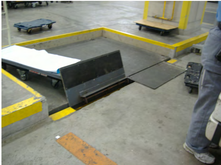
荷さばき施設 リフター緩衝材
