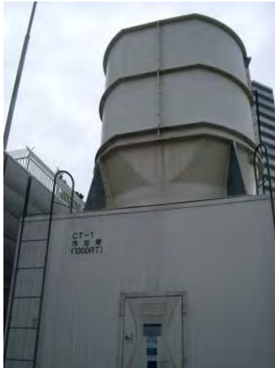
低騒音型冷却塔
