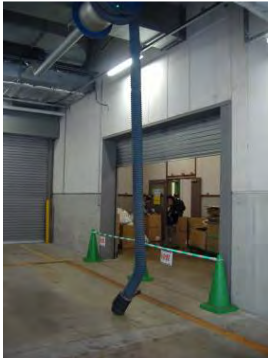
ゴミ処理庫・ゴミ回収車排気ガスホース
