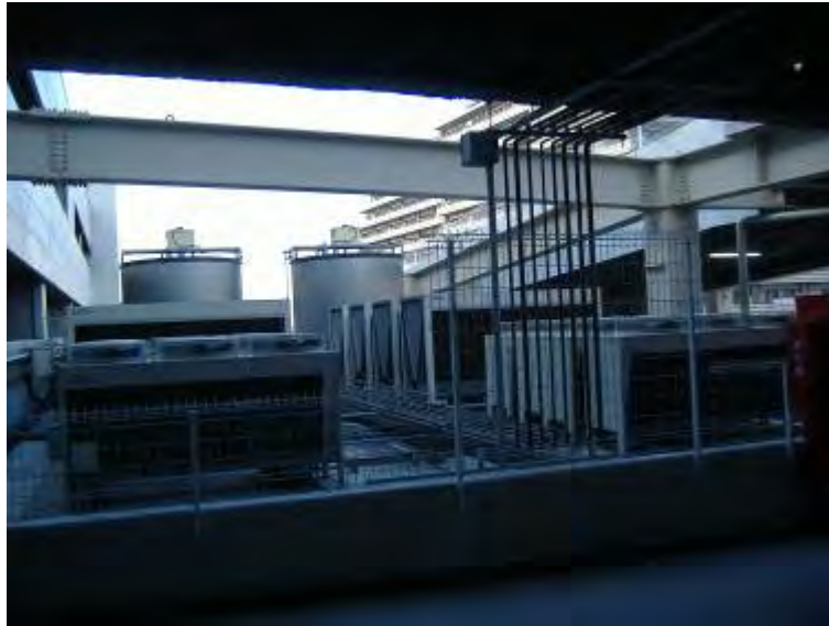
冷却塔・空調室外機置き場
