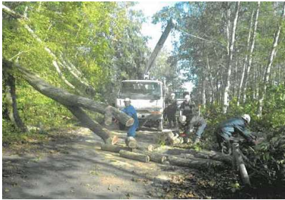
林道の通行に支障となる倒木の処理状況
