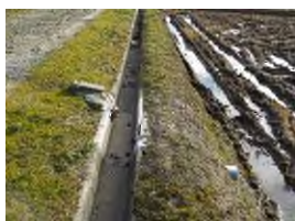
用水路からの漏水状況
