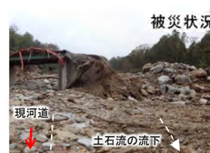
平成28年8月台風による被害状況
