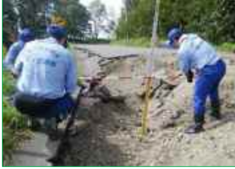
被災調査(道路) (安平町)
