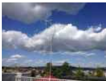
役場屋上に設置された臨時災害放送局のアンテナ
