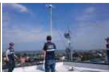
役場屋上に設置された臨時災害放送局のアンテナ
