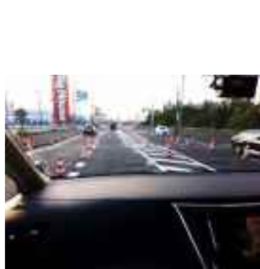
【札幌市清田区】波打つ道路
