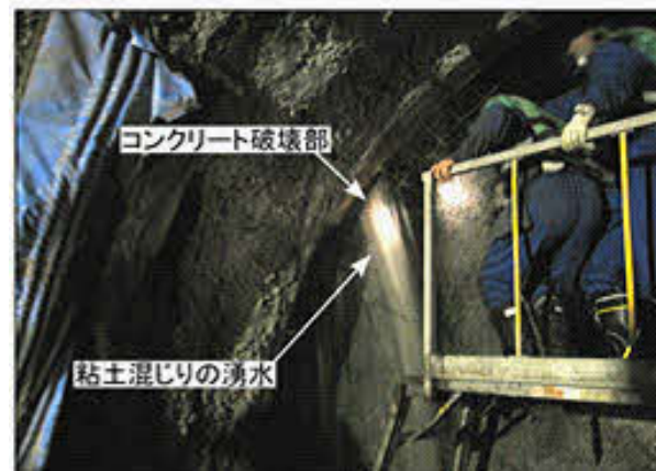
大量湧水発生状況(深度350m)
