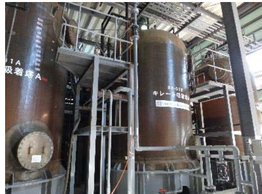
脱ホウ素設備(2号機)
