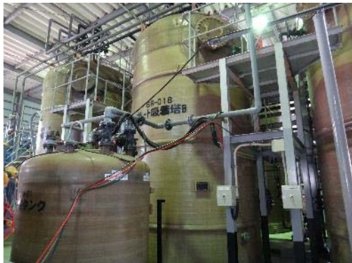
脱ホウ素設備(1号機)
