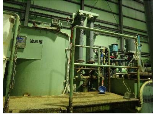
濁水処理設備
