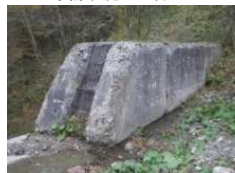
砂防堰堤の老朽化
