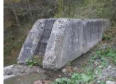
砂防堰堤の老朽化
