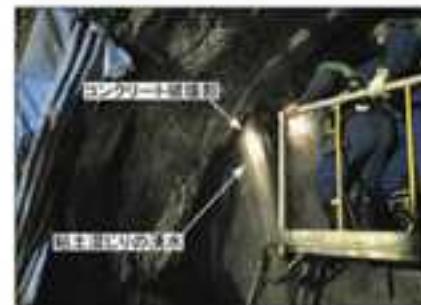
大量湧水発生状況（深度 350m）
