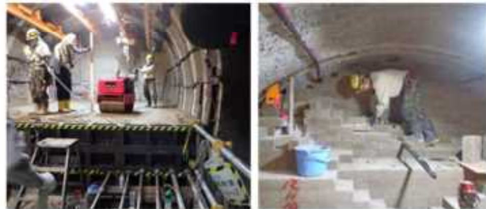
埋め戻し材の施工(左:転圧締め固め、右:ブロック積み上げ)
