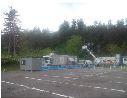
停電地区への 移動発電機車供給
