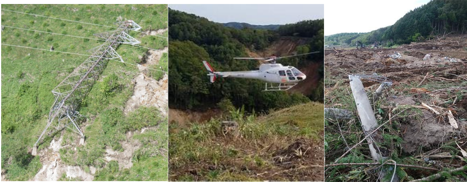
鉄塔倒壊箇所(岩知志線)
