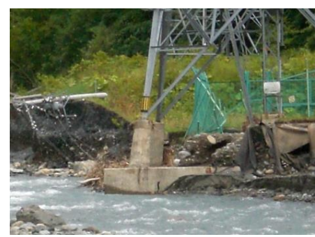
無線鉄塔基礎部の 被害
