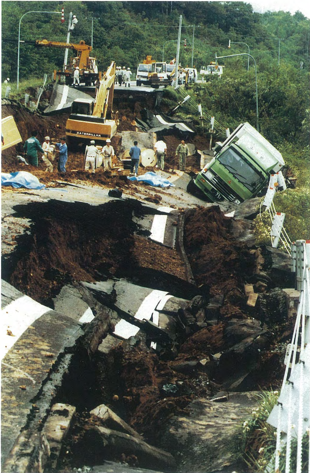
長万部町国道5号線の崩壊〔北海道新聞社提供〕
