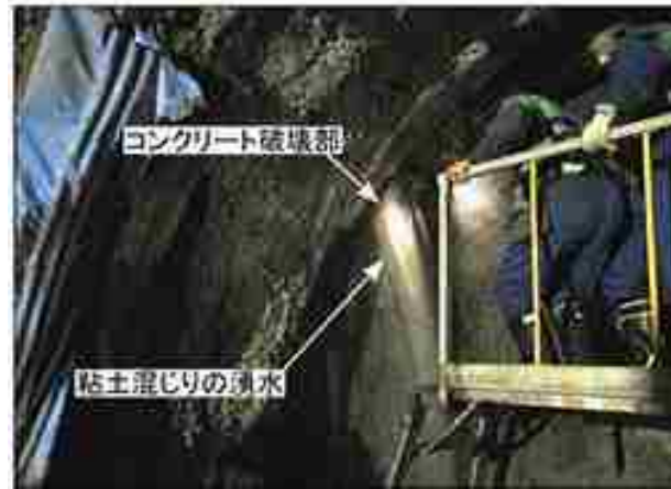
大量湧水発生状況 (深度350m)
