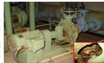
下水道施設の老朽化
