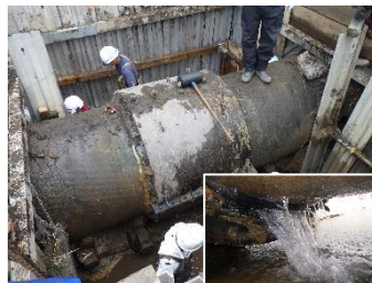
北海道胆振東部地震に伴う漏水
