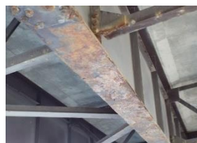
橋梁の老朽化
