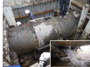
北海道胆振東部地震に伴う漏水
