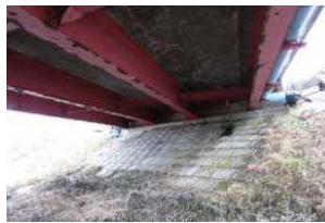
橋梁の老朽化
