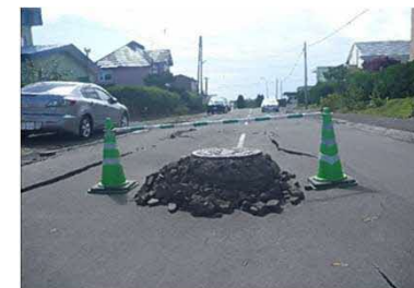
マンホールの突出 (2018.9 安平町)
