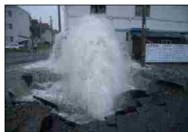
上水道配水管の漏水
