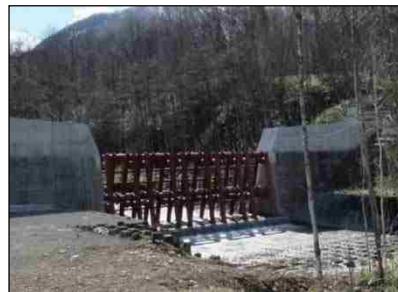
土泥石流等を捕捉する砂防堰堤
