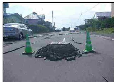
マンホールの突出 (2018.9 安平町)
