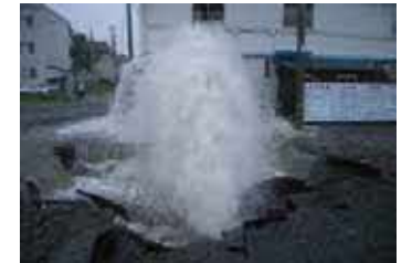
上水道配水管の漏水
