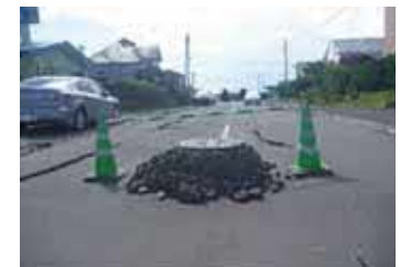
マンホールの突出 (2018.9 安平町)
